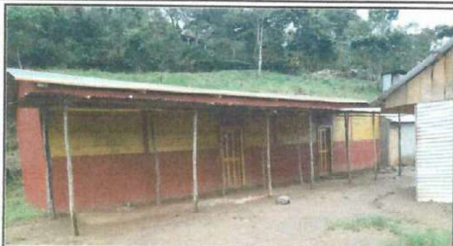
Foto1: Parte frontal del instituto la cual se evidencia la necesidad de rezomozar.
